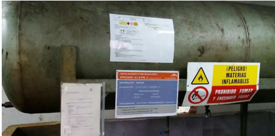
Depósito gasóleo caseta embalse
