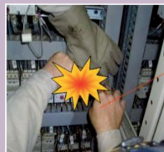
Está estrictamente prohibido realizar ningún tipo de intervención en un panel eléctrico bajo tensión.
