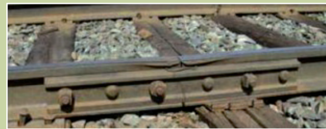
Peligro: el desgaste de los carriles puede provocar un descarrilamiento
