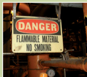
Un buen ejemplo de señalización en zonas con riesgo por gas.
