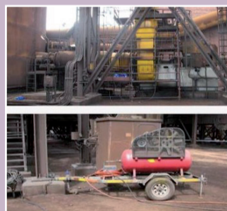
Arriba: un escape de monóxido de carbono a proximidad de esta brida provocó un accidente con una víctima mortal.
