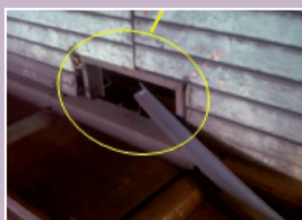
La ausencia de la cubierta de protección permitió el paso del extremo de la barra.
