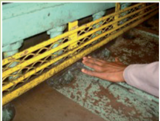
Barrera protectora que impide el contacto con la cizalla.
