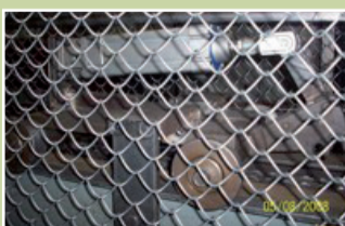
Proceso automatizado y cerramiento para proteger a los empleados y evitar el contacto con posibles puntos de atrapamiento.
