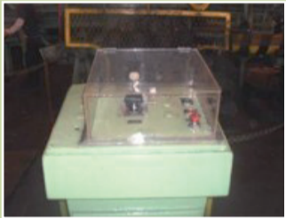
Panel de control protegido con una cubierta de plexiglás.
