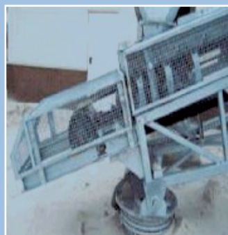
Protección en un sistema de carga.
