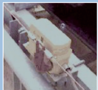
El requisito mínimo en materia de sistemas de seguridad en cintas transportadoras es un cable fácilmente accesible que accione la parada de emergencia.
