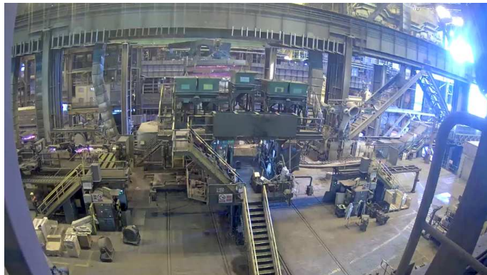
Planchada de colada continua
